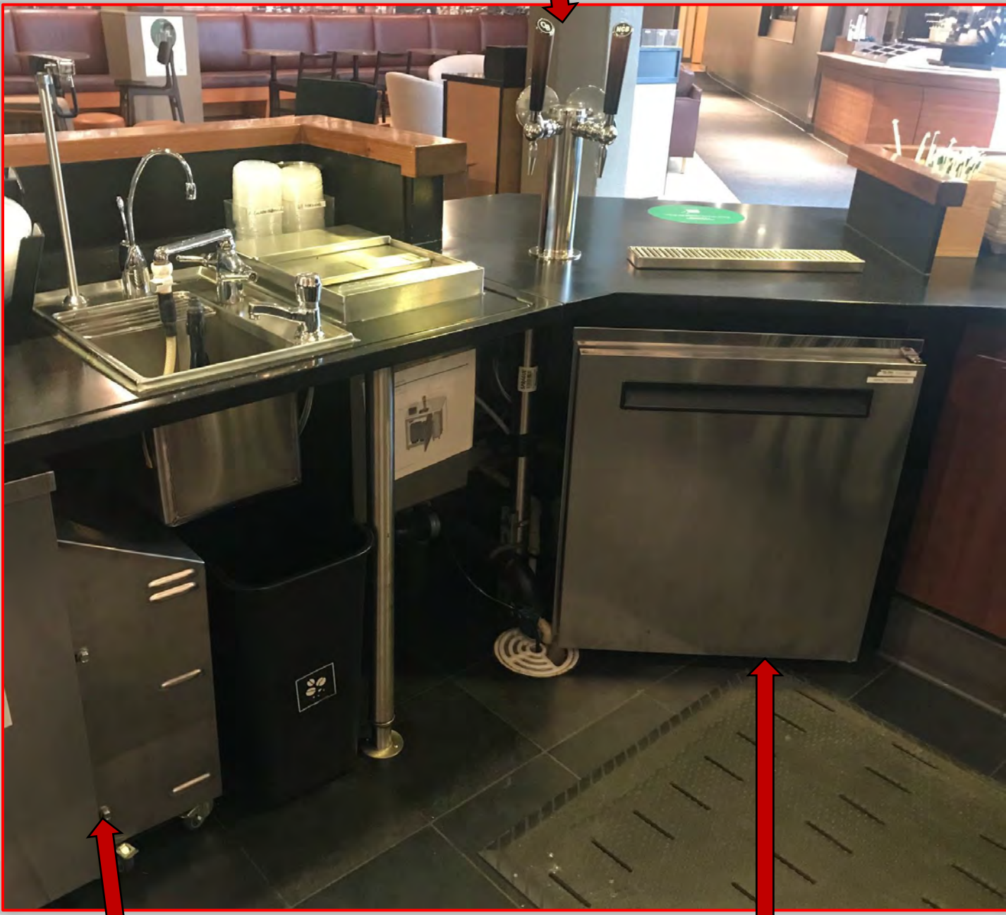
Nitrogen Generator (Tag)
